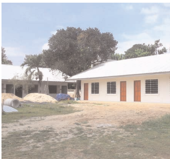
Vårt nya bus står klart och renoveringen på vårt gamla bus har börjat.
